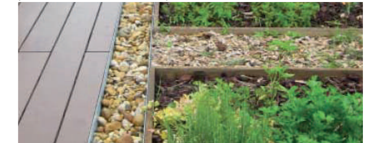
Tranchée drainante étroite (25cm) connectée à des carrés potagers
